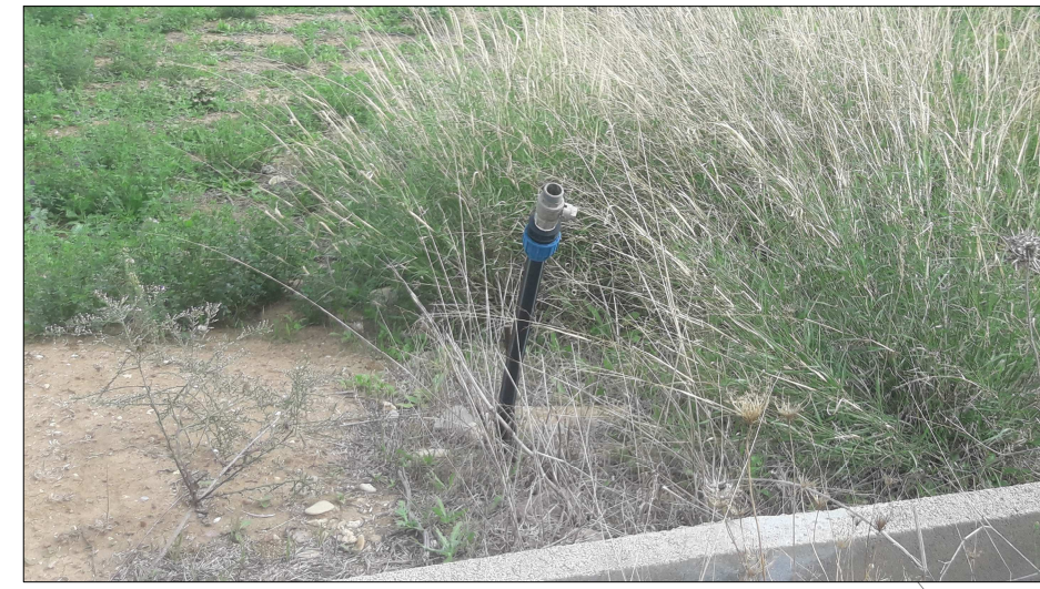
Foto 10 - Particolare rete idrica di adduzione ai lotti
