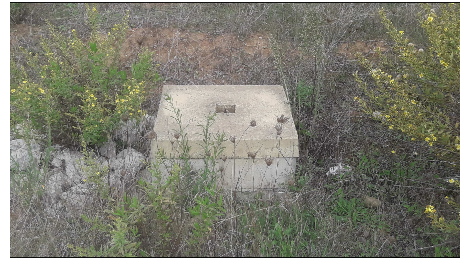
Foto 9 - Particolare pozzetto sifonato rete fognaria
